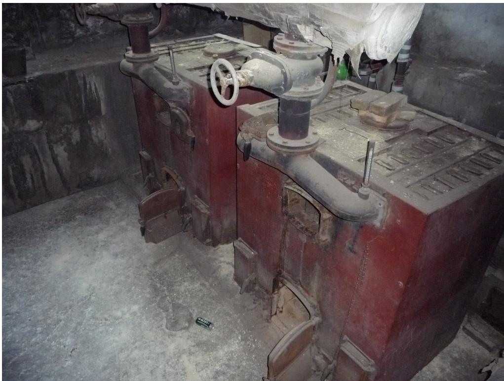
Fot. 19 Budynek szkolny ul. Bocheńskiego 149 – kotły grzewcze do demontażu.
