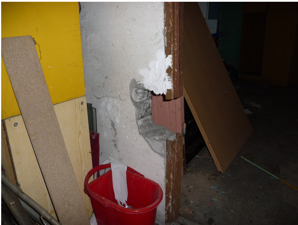
Fot. 31 Budynek gospodarczy A ul. Bocheńskiego 149 – uszkodzona ściana wewnętrzna.
