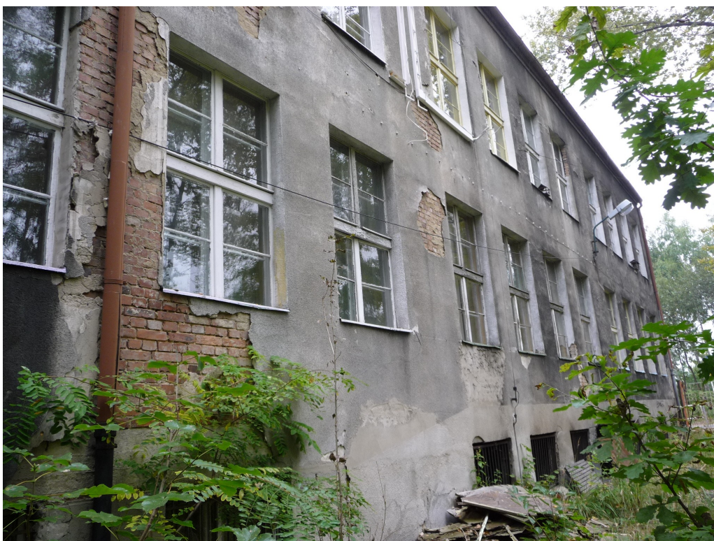
Fot. 16 Budynek szkolny ul. Bocheńskiego 149 – ubytki w elewacji
