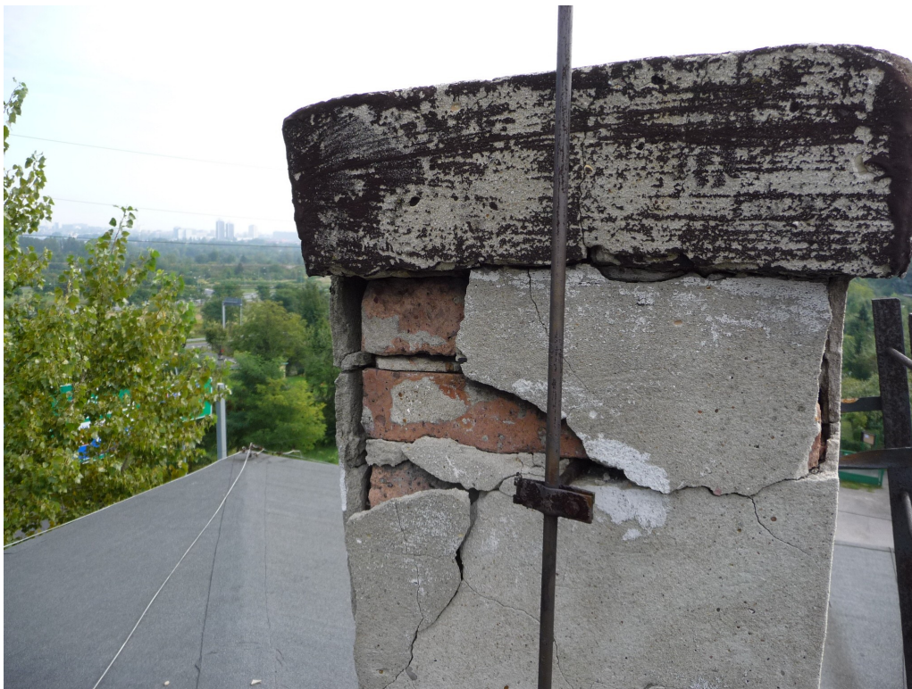
Fot. 25 Budynek szkolny ul. Bocheńskiego 149 – uszkodzony komin.
