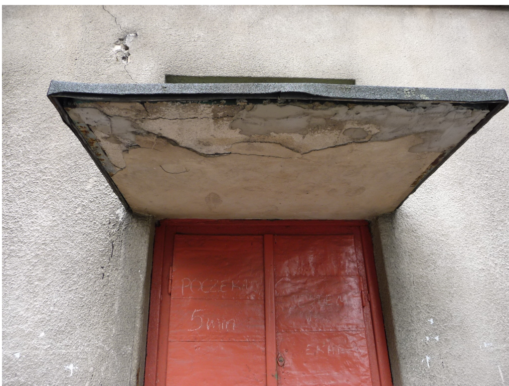
Fot. 32 Budynek gospodarczy A ul. Bocheńskiego 149 – spękania na ścianie elewacyjnej.
