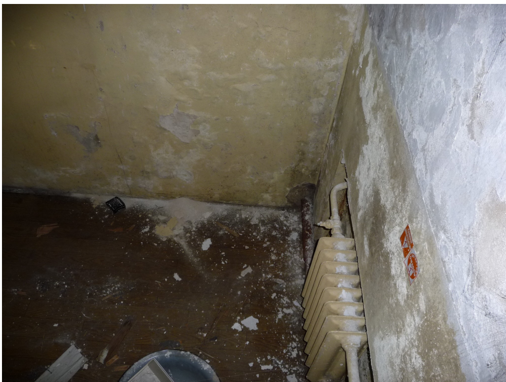
Fot. 20 Budynek szkolny ul. Bocheńskiego 149 część mieszkalna – zawilgocenie i zagrzybienie ścian piwnic w kuchni.
