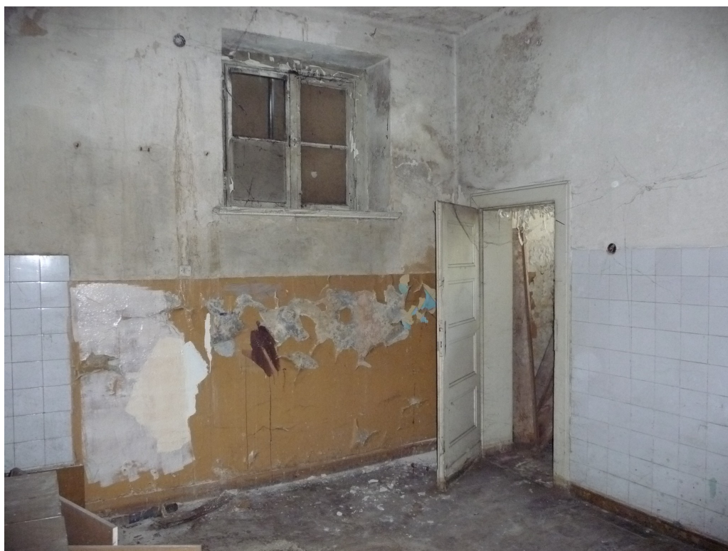
Fot. 23 Budynek szkolny ul. Bocheńskiego 149 część mieszkalna – zawilgocenie i zagrzybienie ścian piwnic.
