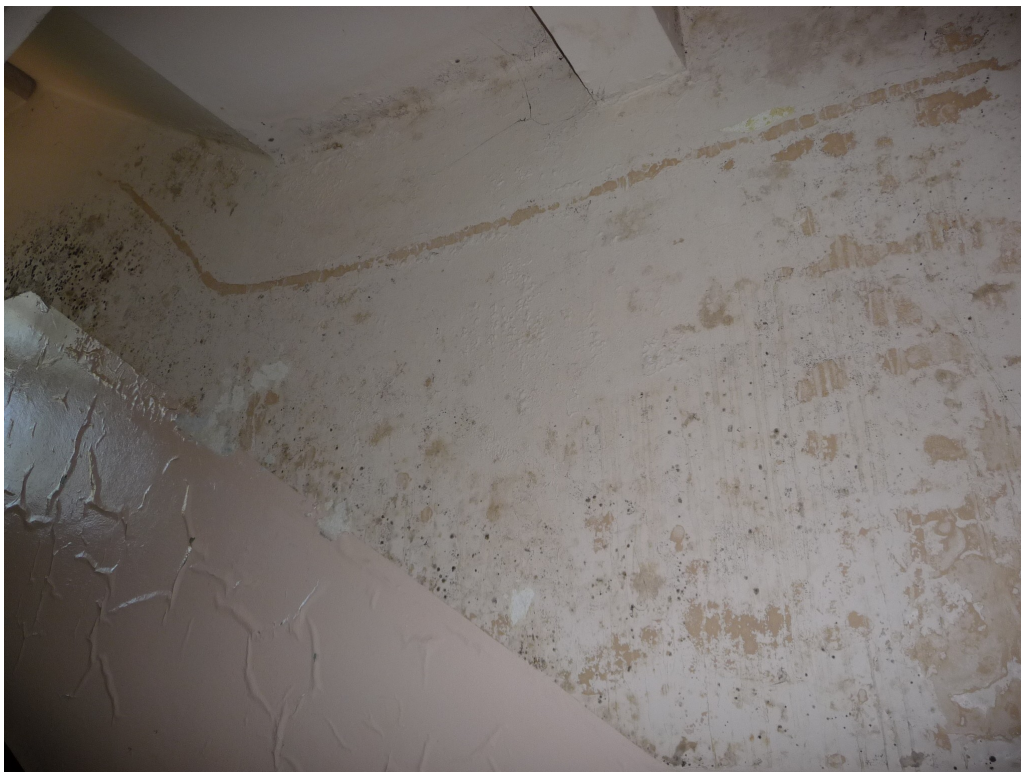
Fot. 21 Budynek szkolny ul. Bocheńskiego 149 część mieszkalna – zawilgocenie i zagrzybienie ścian klatki schodowej.
