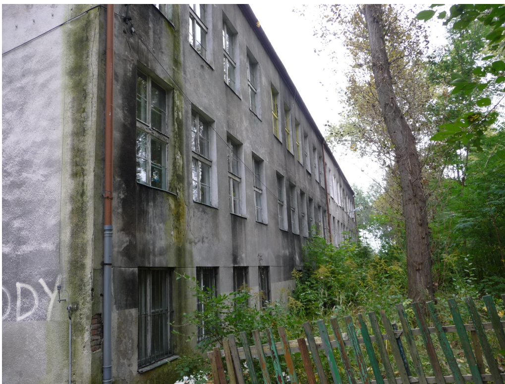
Fot. 17 Budynek szkolny ul. Bocheńskiego 149 – zawilgocona elewacja budynku.
