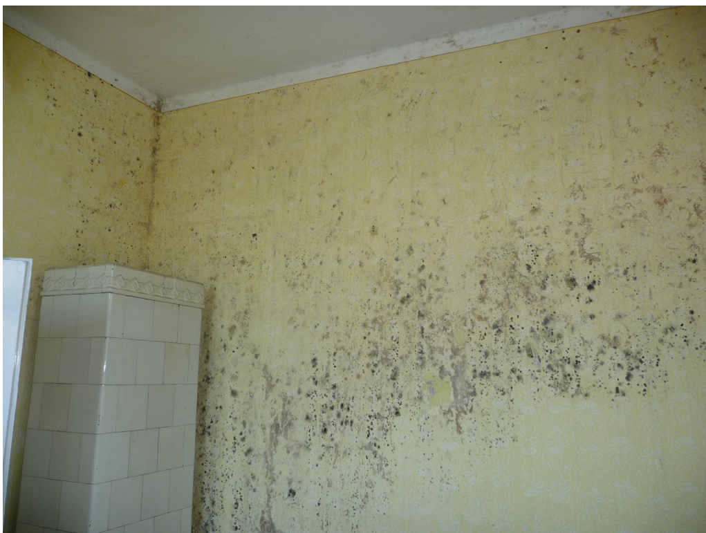
Fot. 22 Budynek szkolny ul. Bocheńskiego 149 część mieszkalna – zawilgocenie i zagrzybienie ścian mieszkań.
