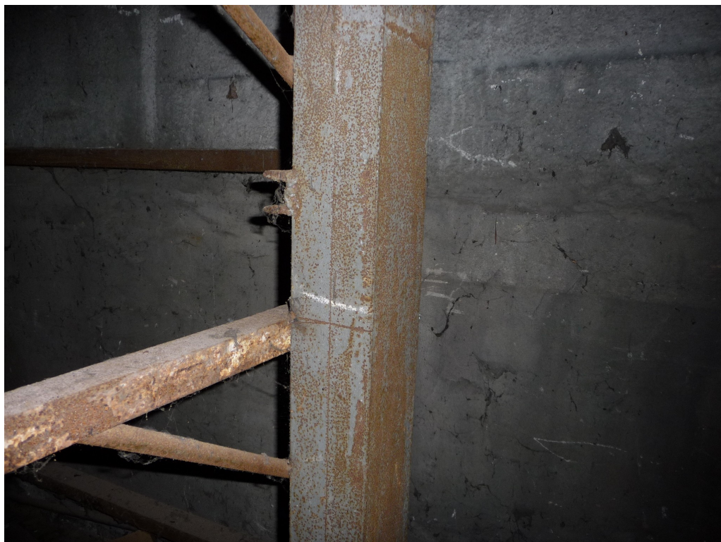
Fot. 18 Budynek gospodarczy B ul. Bocheńskiego 149 – skorodowana konstrukcja stalowa.
